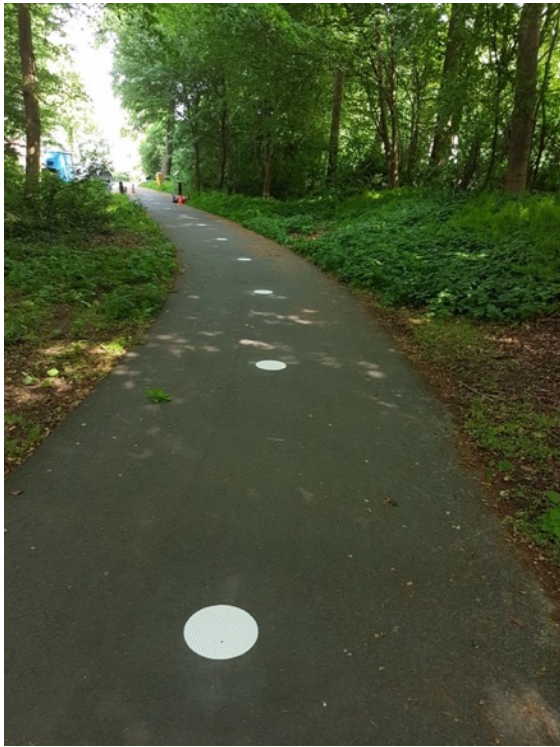
Foto: reflecterende stippen in plaats van verlichting op een doorgaande fietsroute. Zo is het pad goed zichtbaar zonder een lantaarnpaal.
