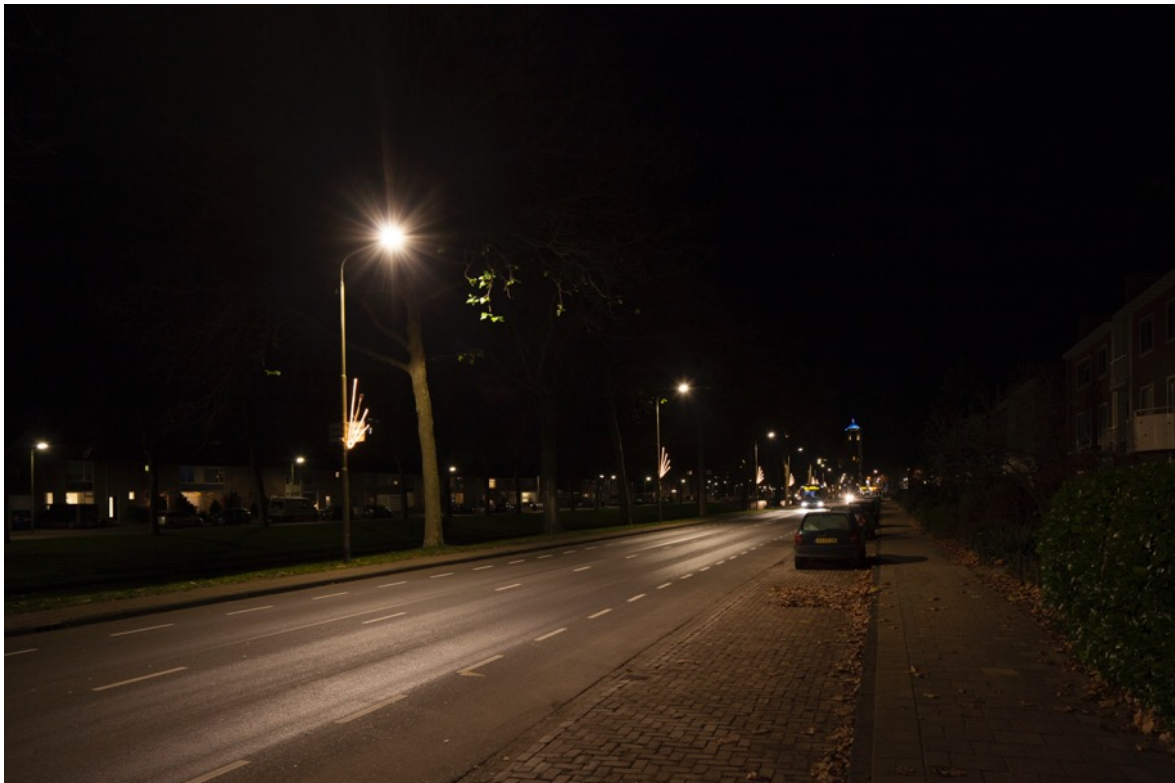
Foto: Langedreef in Emmeloord. Licht is gelijkmatig over de weg verdeeld zodat er geen zwarte vlekken zijn.
